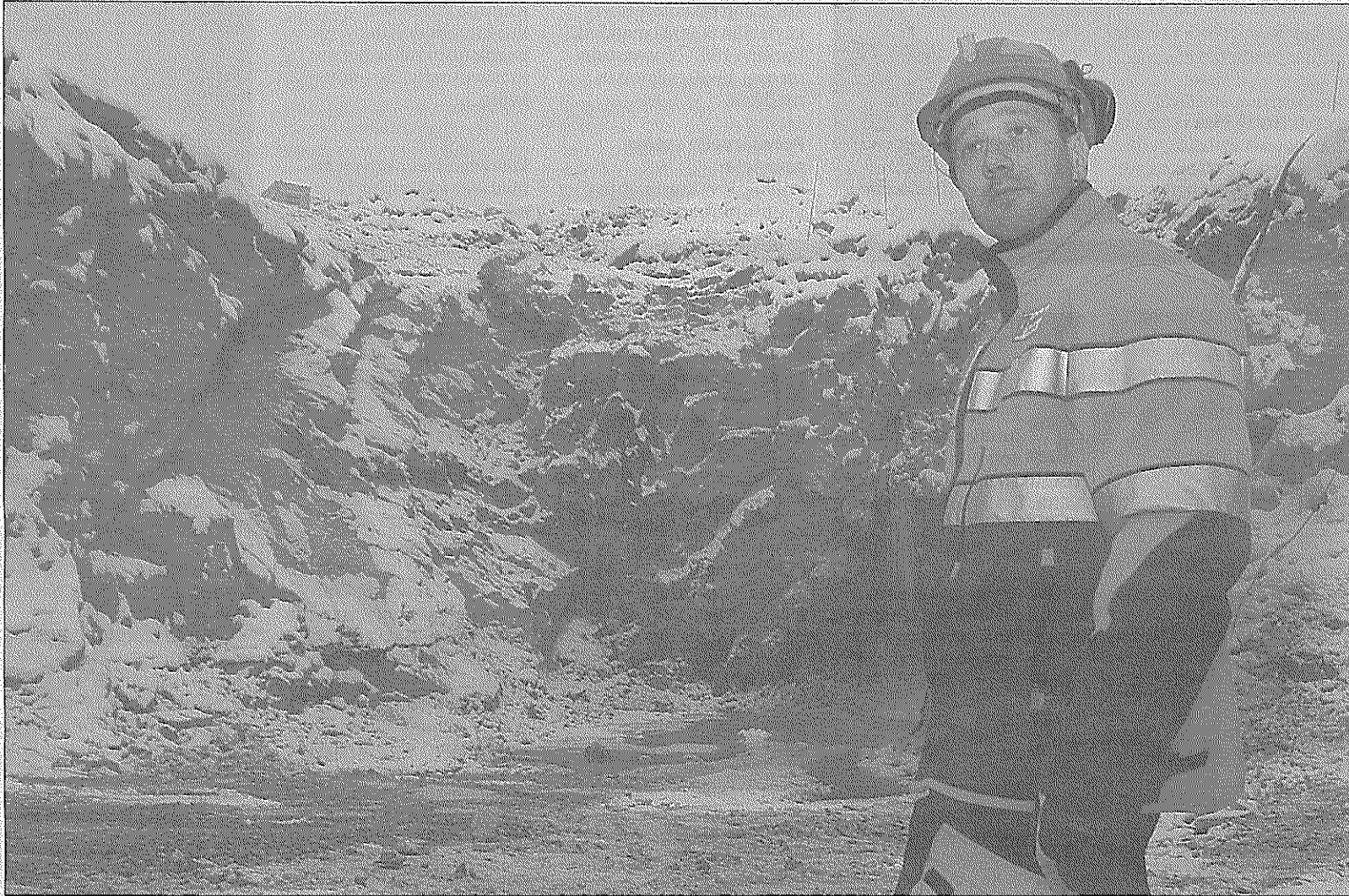
Kaivoksen päällikkö Seppo Tuovinen seisoo vinotunnelin avoleikkauksessa. Vinotunneli lähtee Tuovisen takana näkyvästä seinämästä.
